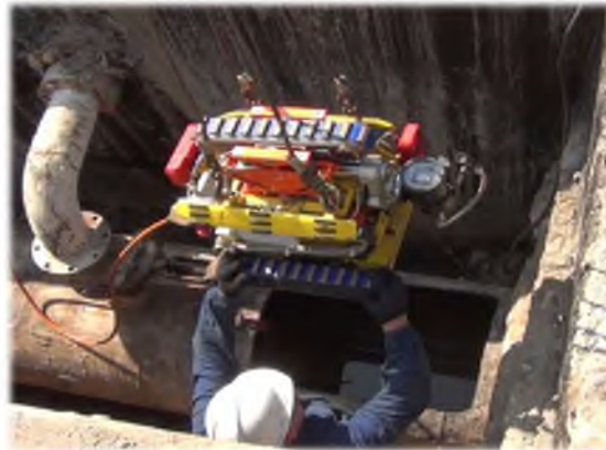
Трубопроводы тепловых сетей, Россия
