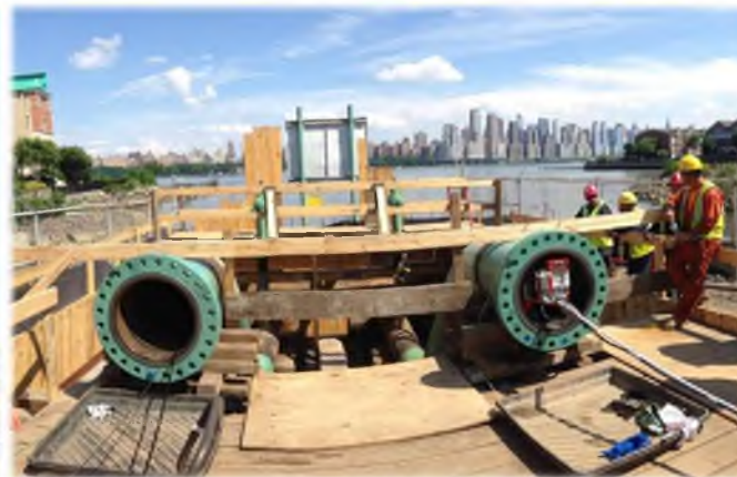
Газопроводы "Williams" Нью-Йорк, США
